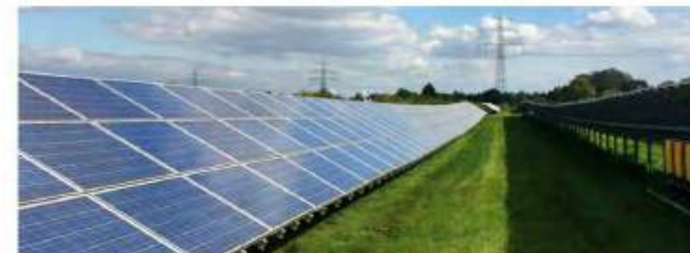
© ABO Wind – Table de modules - Parc photovoltaïque de Malbom en Allemagne
