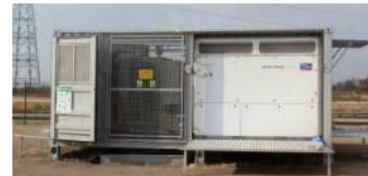
Figure 24 : Illustration du poste de conversion qui sera mis en place sur le projet de Bazac (ABO Wind)
